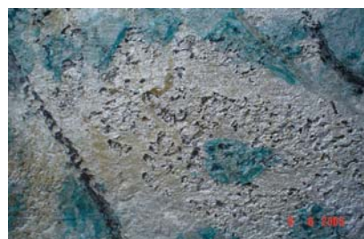
Rys. 6. Wady na ścianie zewnętrznej kadzi Fig. 6. Defects on the external ladle wall
