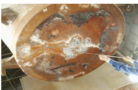
Rys. 3. Pęknięcie wzdłużne dna kadzi Fig. 3. Lengthwise crack in the ladle bottom
